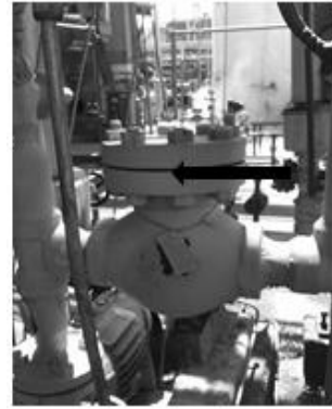
Figura 7. Punto de posicionamiento para una válvula tipo Check. Fuente: Elaboración propia
