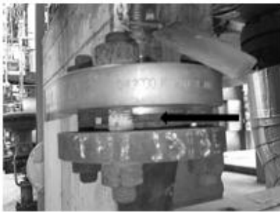
Figura 5. Punto de posicionamiento para una unión bridada. Fuente: Elaboración propia
