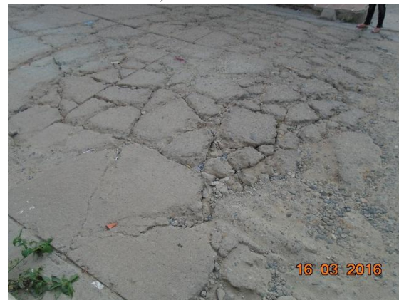
Figura 7. Fallo típico en pavimento rígido.
