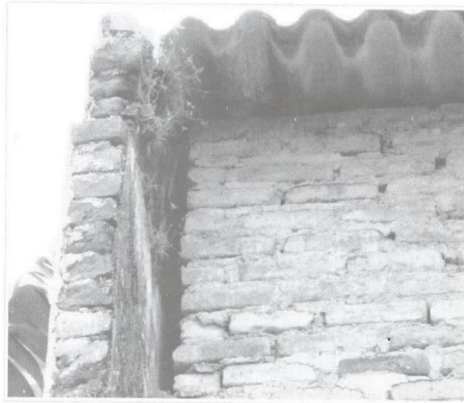
Fotografía 4. No existen columnas de confinamiento alrededor de los muros 5 .
