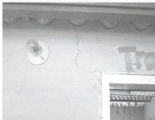
Fotografía 10. Grietas en muros escuela el Carmen 6 .
