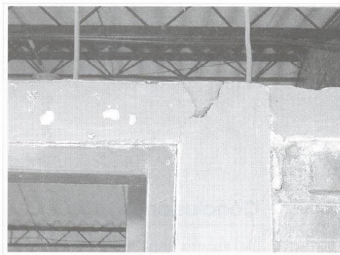
Fotografía 12. Grietas en muros escuela Nuestra Señora de Torcoroma 6 .
