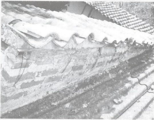
Fotografía 3. No existen vigas de amarre a nivel de cubiertas 5 .
