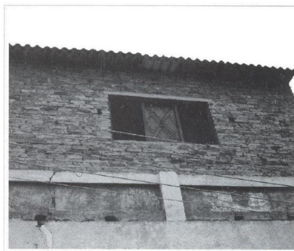
Fotografía 2. No existen columnas de confinamiento alrededor de los muros de la escuela Adolfo Milanés 5 .
