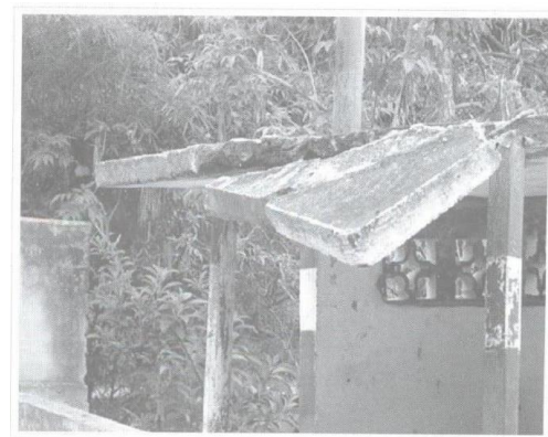
Fotografía 8. Daños en la cubierta de concreto escuela Nuestra Señora de Torcoroma 6 .
