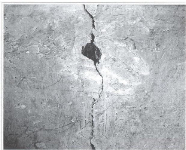
Fotografía 1. Imágenes de grieta en un salón de la escuela Adolfo Milanés 5 .
