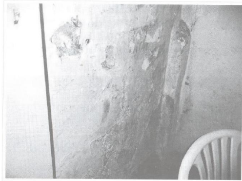
Fotografía 6. Los muros son de tapia pisada y presentan gran deterioro 5 .
