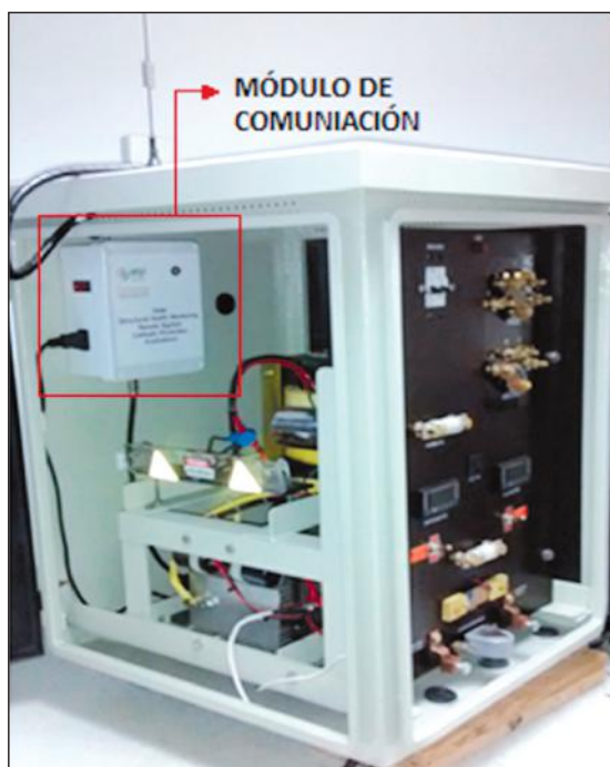
Figura 6. Montaje de módulo de monitoreo en un rectificador Fuente: Autores.
